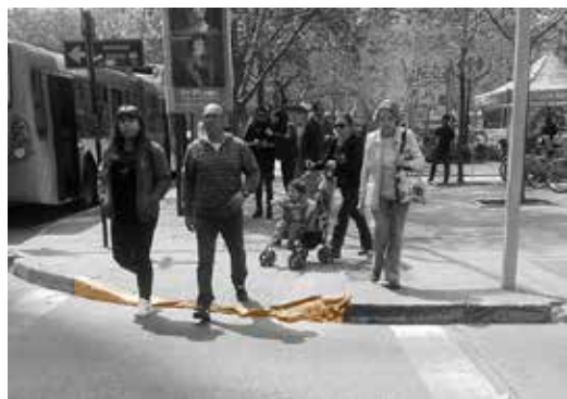
Figura 15: Falta de mantenimiento en rampas.
