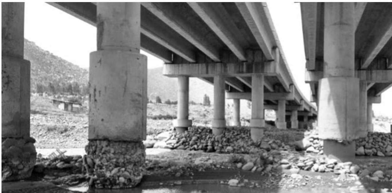
Figura 3. Puente del río Maipo deteriorado por la socavación de las fundaciones
